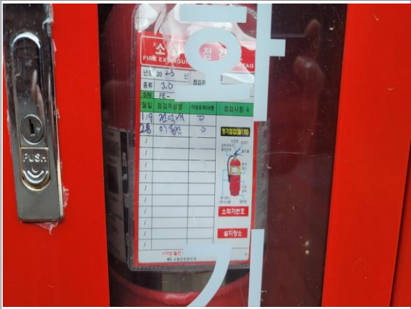
내 용 소화기 미점검
