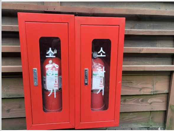
내 용 소화기 미점검
