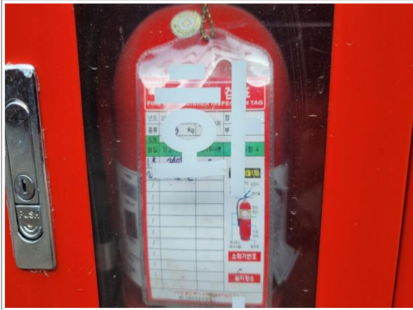
내 용 소화기 미점검
